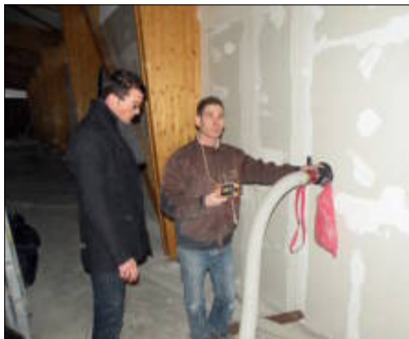
L'isolation, selon la technique d'injection à sec, est issue du recyclage de journaux par l'usine Cellaouate, qui fabrique de la ouate de cellulose à Saint-Martin-des-Champs.
