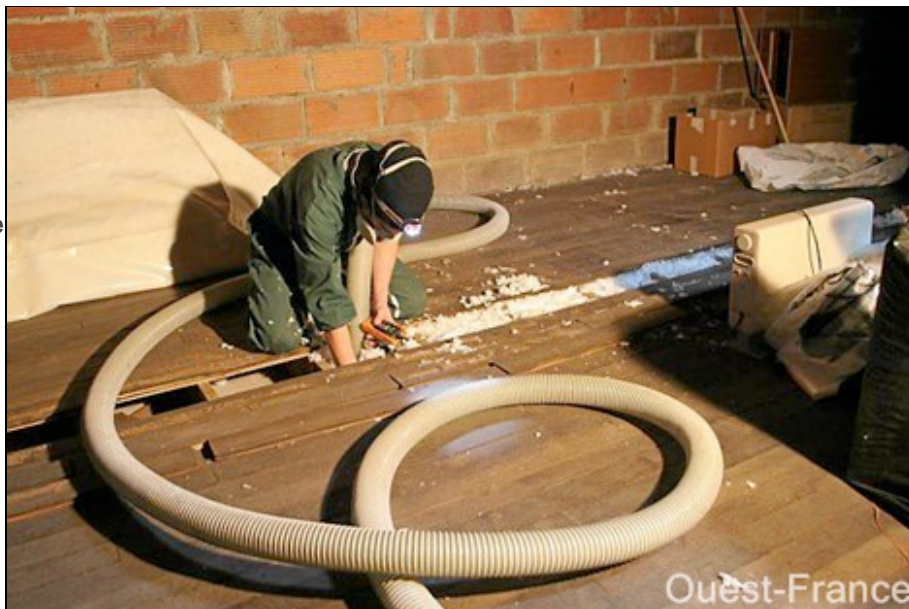
De la laine minérale est insufflée entre le plafond et le plancher du grenier. Une façon de limiter les pertes de chaleur.
